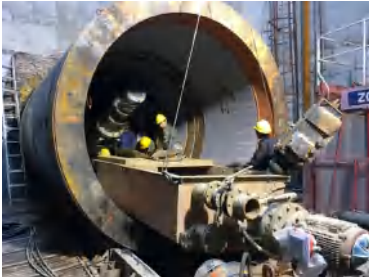
泥水转换装置
