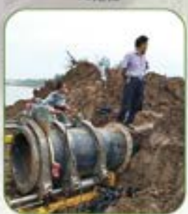
青岛排污排水
