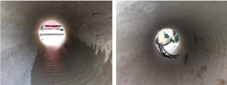
图 2 模拟台架管道排水后表面状态变化
