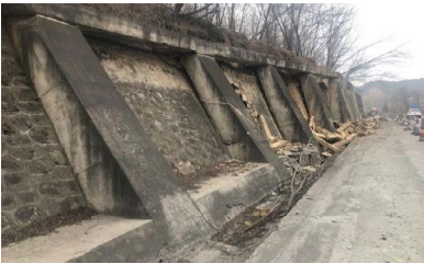
图 2 G316 国道边坡挡墙破坏
