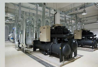
北京世界园艺博览会综合供能工程
