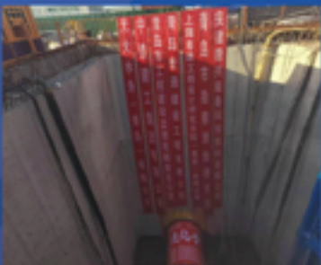
麦岛污水处理厂排海 管道（海域段）
