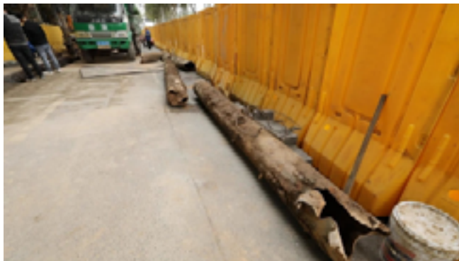
替换前（老旧钢管）严重形变管身已严重腐蚀
