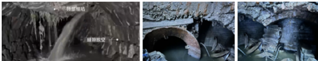
图 3 浆砌石箱涵修复前的情况
