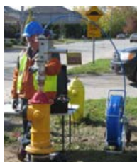
图 2-99 典型小直径 CCTV / 声学检测装置
