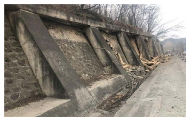
图 2 G316 国道边坡挡墙破坏
