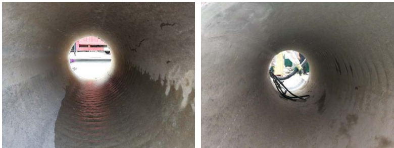
图 2 模拟台架管道排水后表面状态变化
