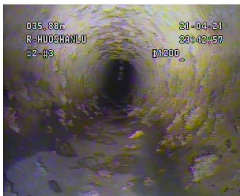
图 7 超高压清洗管道前原始情况
