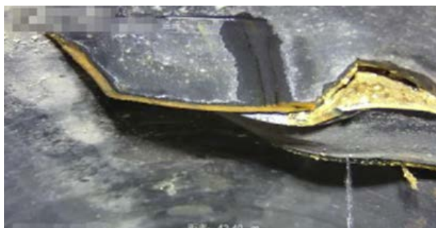
图 5 CCTV 检测成果（破裂和渗漏）
