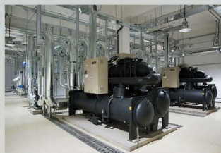
北京世界园艺博览会综合供能工程
