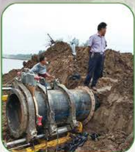
青岛排污排水
