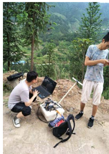
上山帮业主测供水管道漏水
