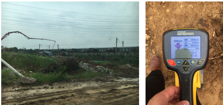
（图三）铁路两侧有跟穿越的大埋深管线，深度在9.09米
